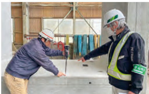
プローブを使用し、お客様と確認しながら測定を行います
